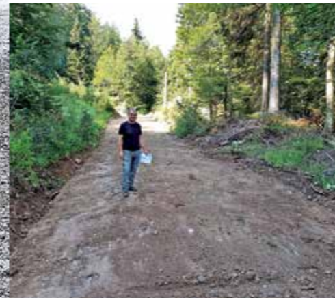
Unzureichende Wasserhaltung führte zur Ausschwemmung der Fahrbahn.
