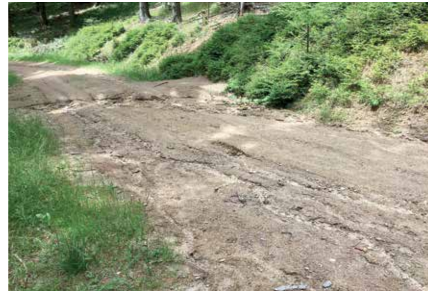
Eine unzureichende Wasserableitung verursacht ein Ausschwemmen der Straße.
